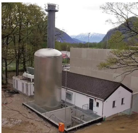
Das neue Heizblockkraftwerk
